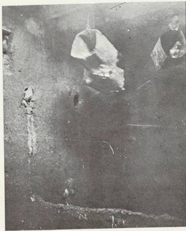
(ح) صفايح قديمة مستعملة كبناني للحمام ، يلاحظ الحمام معشش داخل الحيطه
