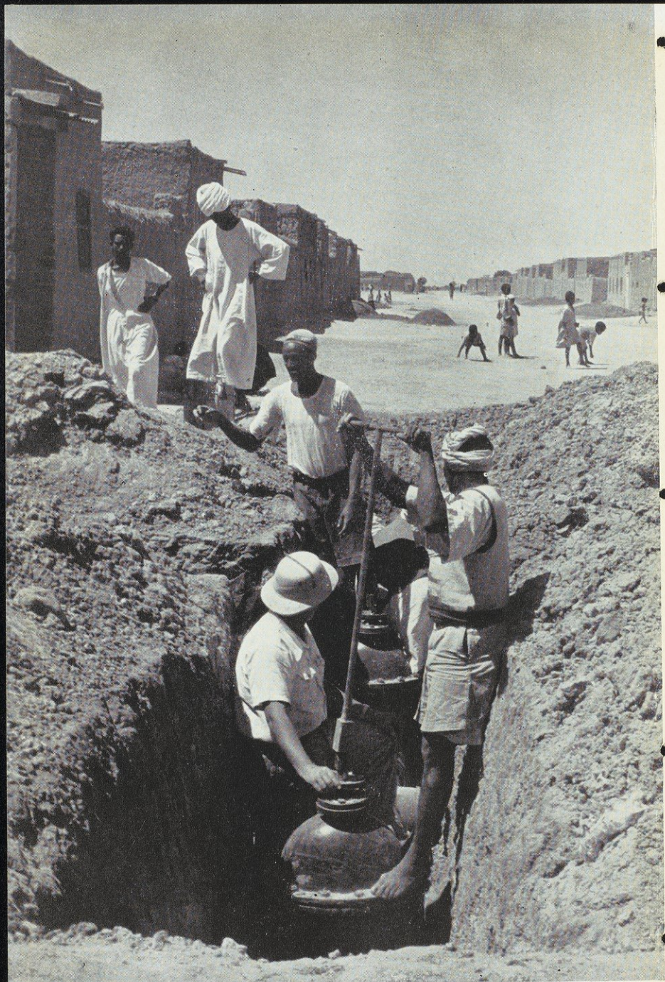
يقوم المجلس البلدى بالخرطوم الان ببناء احياء جديدة للعمال وترى انابيب المياه وهي تمتد في احد الشوارع الفسيحة المأهولة.
